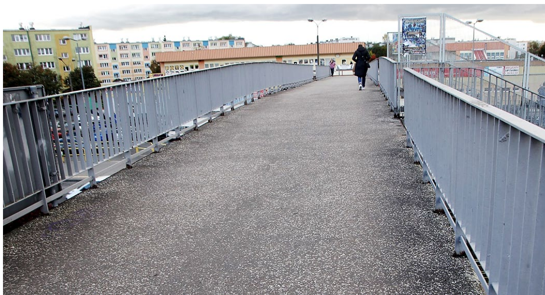
Kładka na Wyżynach powstała w 1982 roku. Jej stan techniczny sprawia, że konieczna będzie rozbiórka. Mieszkańcy zadecydują, czy w zamian powstanie nowa przeprawa czy przejście naziemne.
